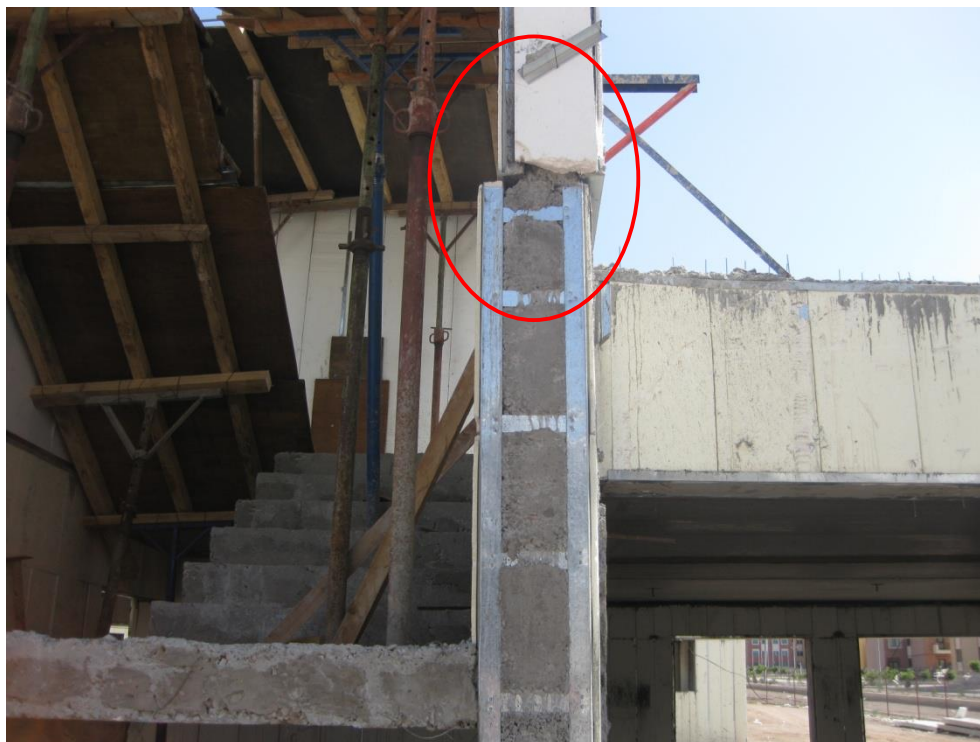
شکل ۲-۱۵: وجود برخی مشکلات اجرایی از جمله خروج از محوریت در اجرای پانلهای قائم دیوار
