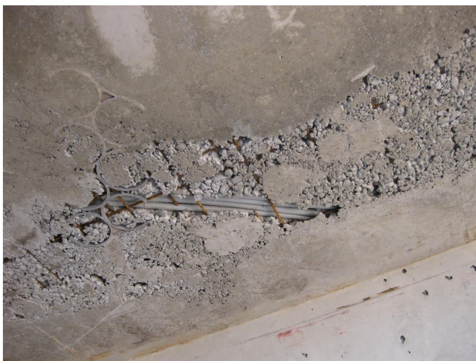
شکل ۲-۳۶: وجود برخی ناهنجاری ها از جمله کرمو بودن سطح بتن ریزی شده پس از باز کردن قالبها در صورت رعایت نکردن استانداردهای بتن ریزی در سیستم قالب تونلی
